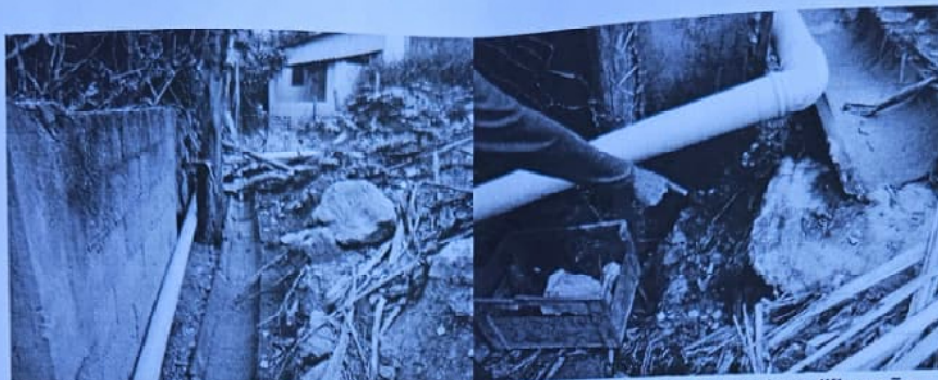
Figura 2 – Detalhe da canelela com partes de infiltrações no muro da edificação
