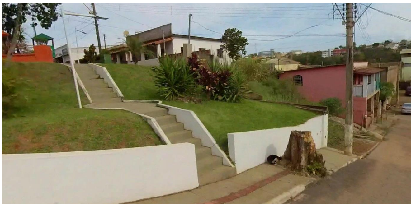
Figura 14: Praça República Dominicana, acesso por escadaria pela rua República da Venezuela. Ausência de guarda-corpo e corrimão. Nota-se ainda calçada obstruída por tronco de árvore já suprimida. Fonte: Google Street View, 2023.
