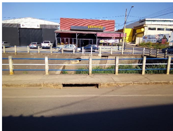
Foto 15: Sistema de drenagem pluvial na avenida Waldomiro Nunes Ferreira.
