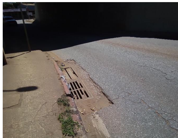
Foto 79 Sistema de drenagem pluvial na rua Perina Venceslau do Prado.
