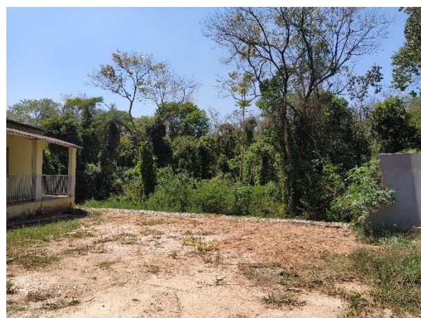
Foto 45: Muro de arrimo no leito do curso d'água e parte do que restou do muro do CRAS Nair da Silva Couto (Jardim das Roseiras) que será reconstruído.
