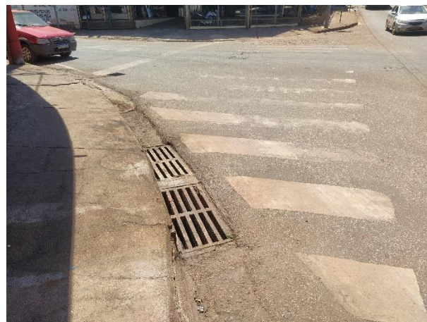
Foto 66: Sistema de drenagem pluvial na rua Bernardino da Silva Couto.
