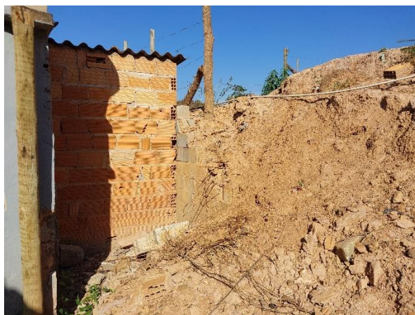
Foto 149: Local de desmoronamento do muro de contenção na rua São Pedro.
