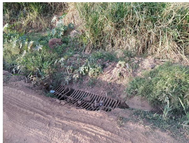
Foto 119: Sistema de drenagem pluvial da rua Jacomino de Moura.
