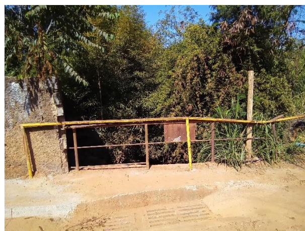
Foto 39: Sistema de drenagem pluvial na rua Minas Gerais no bairro Vila Madalena.
