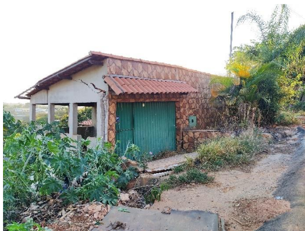
Foto 120: Edificação que estava interditada e evacuada na rua Jacomino de Moura no dia da visita a campo.
