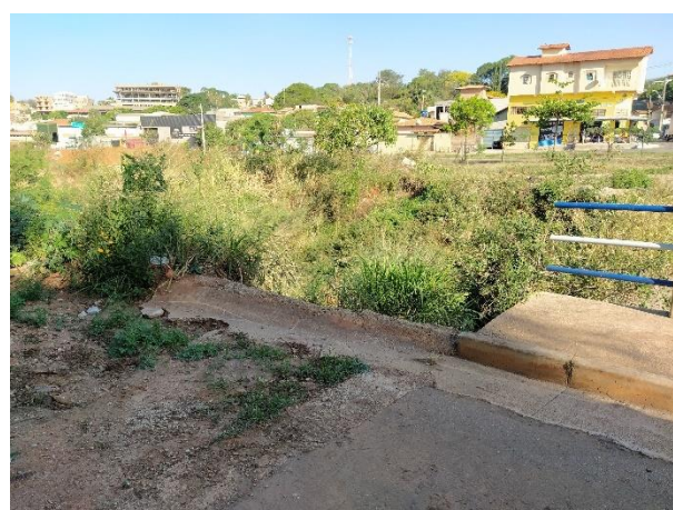
Foto 109: Área de deslizamento no córrego Fundo na avenida Waldomiro Nunes Ferreira no bairro Padre Eustáquio 2ª Seção.
