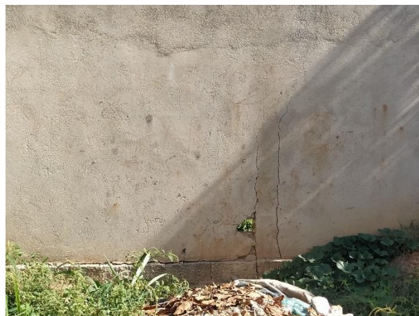
Foto 139: Trinca em muro na rua Itaguara.
