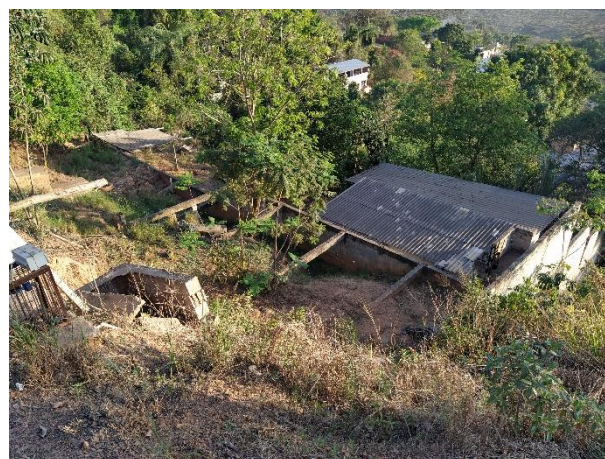
Foto 117: Área de deslizamento na rua Jacomino de Moura.
