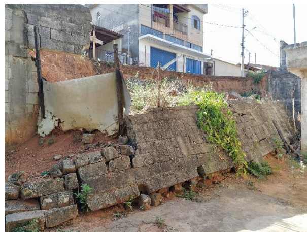
Foto 152: Muro de arrimo que desmoronou na rua Vicente de Souza Ferreira, nº 107.
