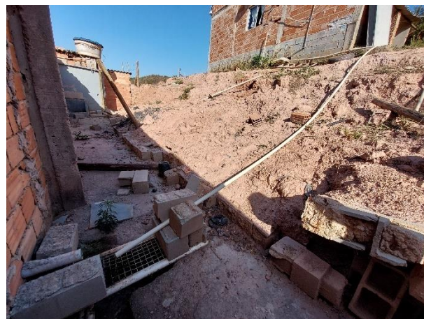
Foto 148: Local de desmoronamento do muro de contenção na rua São Pedro.
