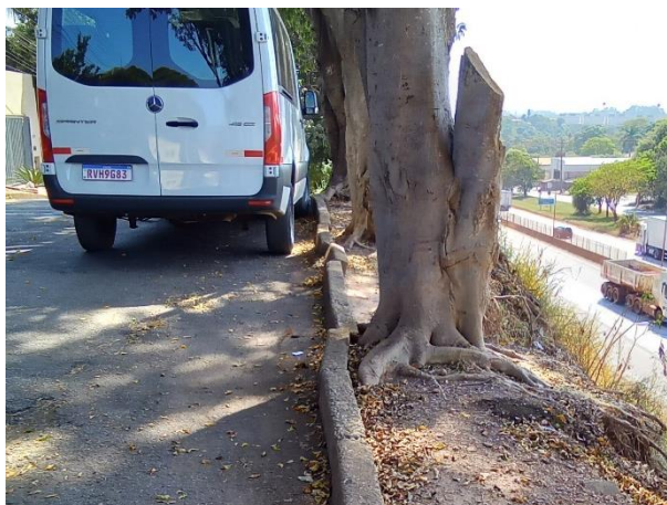
Foto 113: Irregularidades no meio-fio na parte superior do talude e árvore com raízes expostas.
