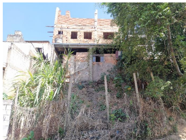
Foto 154: Resquícios de deslizamento ao fundo de lote voltado para a rua Minas Gerais.
