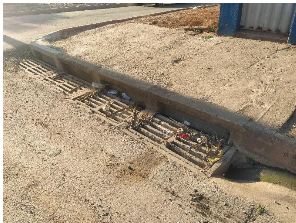
Foto 86: Sistema de drenagem pluvial da avenida Vinte e Seis de Abril.
