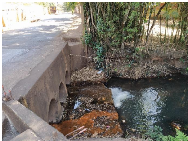
Foto 6: Córrego do Rego ou Vista Alegre no bairro Cidade Nova.
