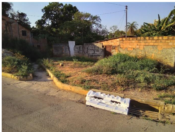
Foto 82: Sistema de drenagem pluvial da avenida José de Souza França.
