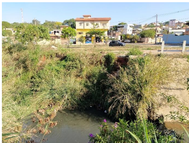
Foto 110: Área de deslizamento no córrego Fundo na avenida Waldomiro Nunes Ferreira no bairro Padre Eustáquio 2ª Seção.
