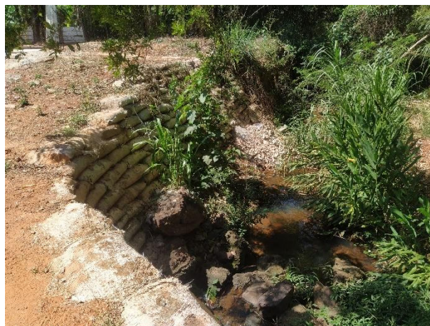
Foto 107: Margem do córrego Fundo ao final da rua Sete de Setembro.
