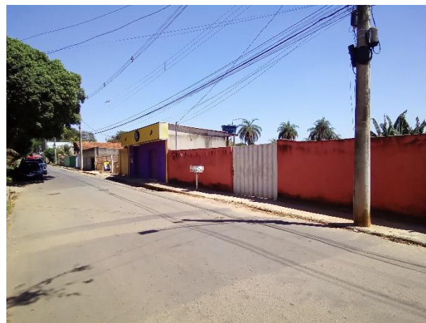
Foto 72: Presença de mofo na base dos muros possivelmente causada pelos alagamentos na rua Arcanja.
