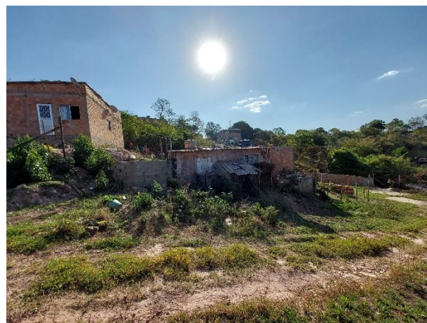
Foto 150: Casa evacuada por tempo indeterminado na rua São Pedro.
