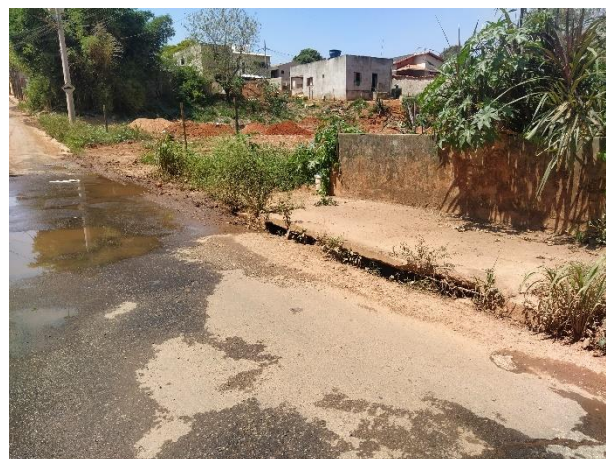
Foto 51: Sistema de drenagem pluvial precário na rua Tarsila do Amaral.
